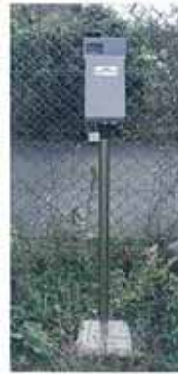
① 灌水設備
