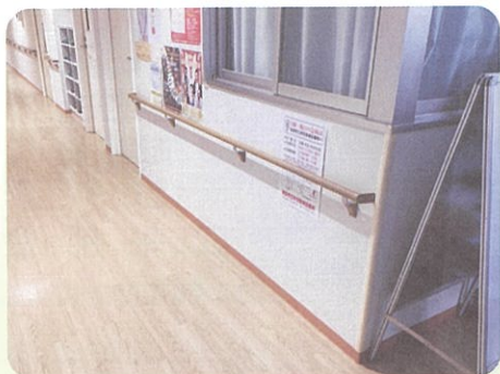
①地域内会館設備改修事業 (石橋会館内手すり設置 10月)
