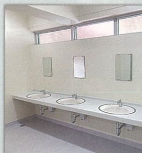
↑ 女子トイレ手洗い場
